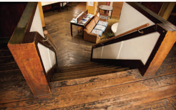
すり減ったふみ板や手すりを見ると建物の年月を感じる。
